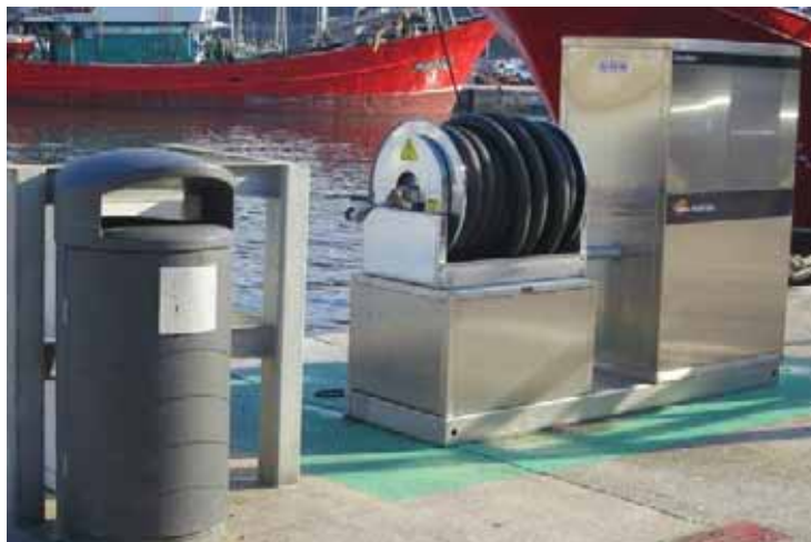
Uno de los surtidores de gasoil del muelle.
